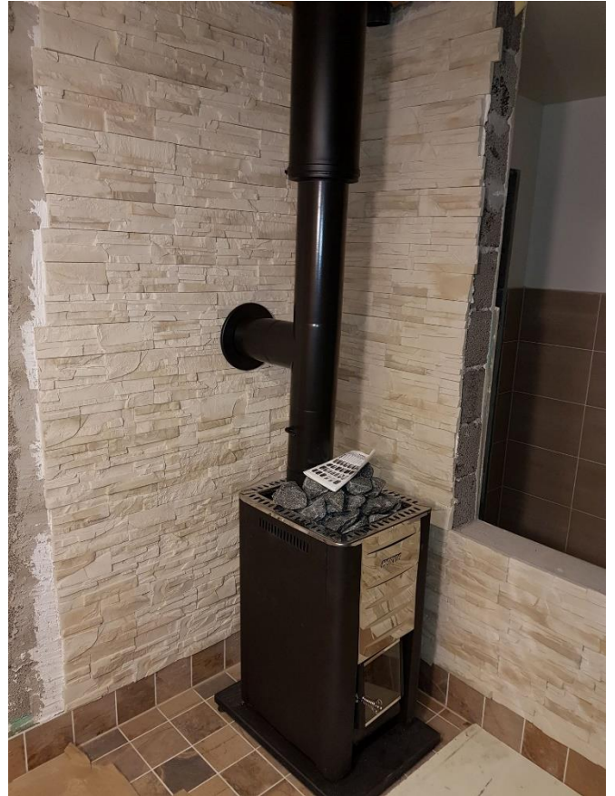
Ovan: Harvia bastukamin installerad mot delad Biomodul-skorsten.
