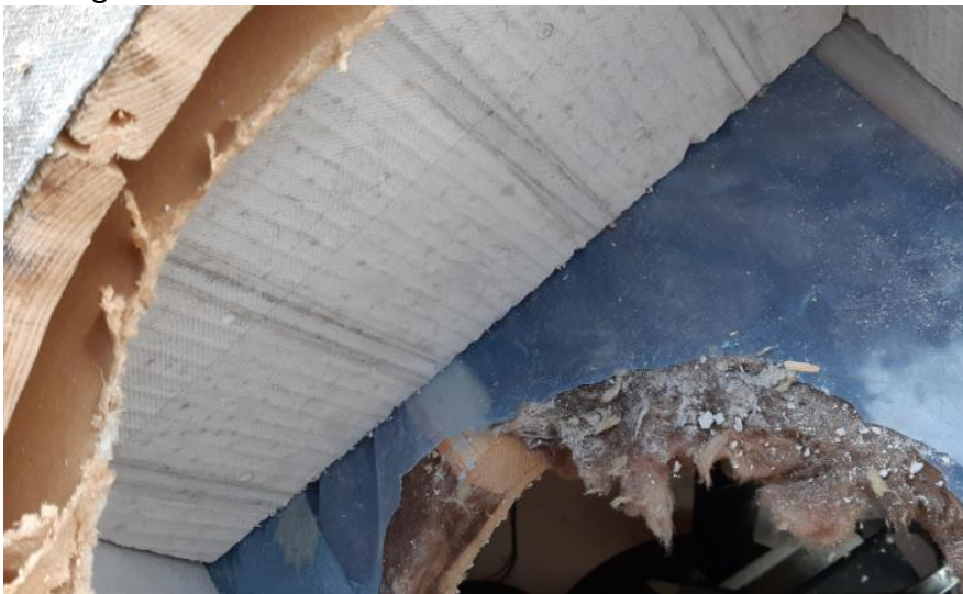
Ovan: Exempel på schakt i snedtak. Schaktet har byggts med 3 cm tjocka kalciumsilikatskivor. I förgrunden skymtar råsponten.
